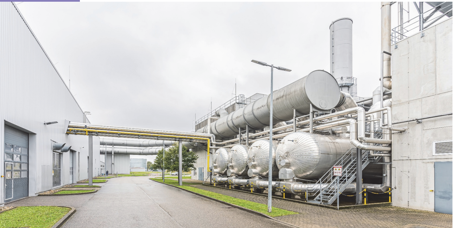
Abbildung 9: Adsorptionsanlage im Toluolkreislauf
